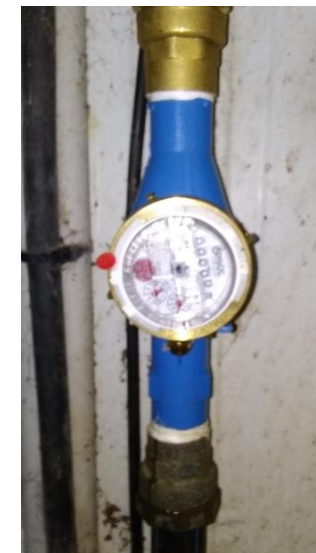
Figure 3 : photo du compteur posé
